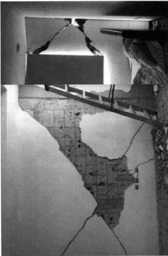
Figura 20.- Daños en mampostería de muro de diafragma. Fuente: de la Cruz et al., (2017).
