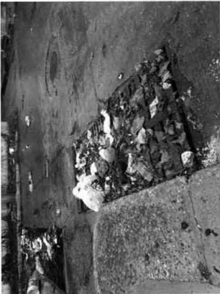
Figura 52.- Residuos sólidos obstruyendo coladeras. Fuente: ICCOM, 2020.
